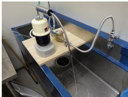
左図：浄水器「マグ・ソフィア」設置状況
